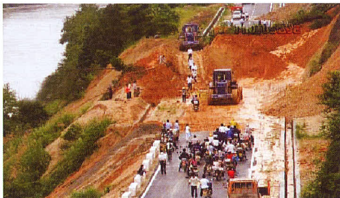
会杉公路滑坡现场
