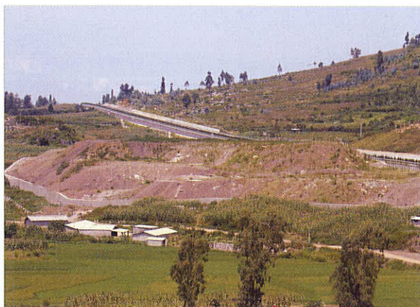
■ 云南砚平高速公路弃渣场挡墙
