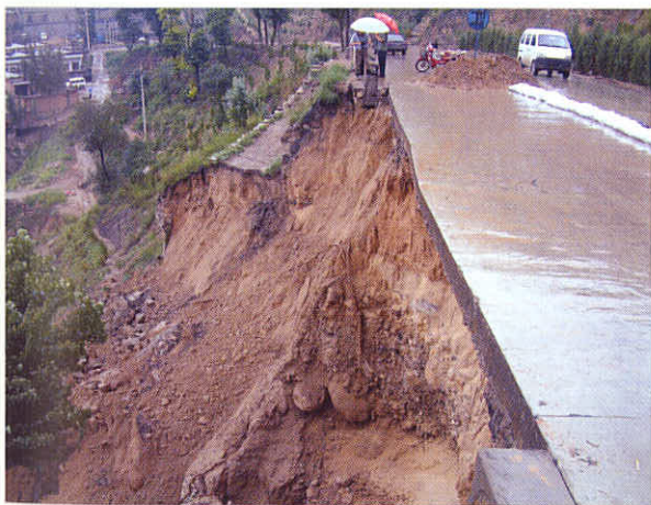
■ 翼城县山体滑坡造成道路阻断
