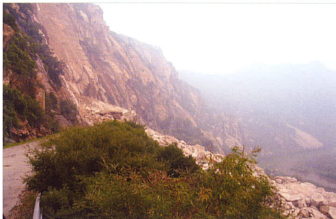
■ 密云县石城镇张家坟村被冲毁的公路
