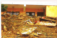
泥石流涌堵了省级重点学校—宁陕小学教学大楼
