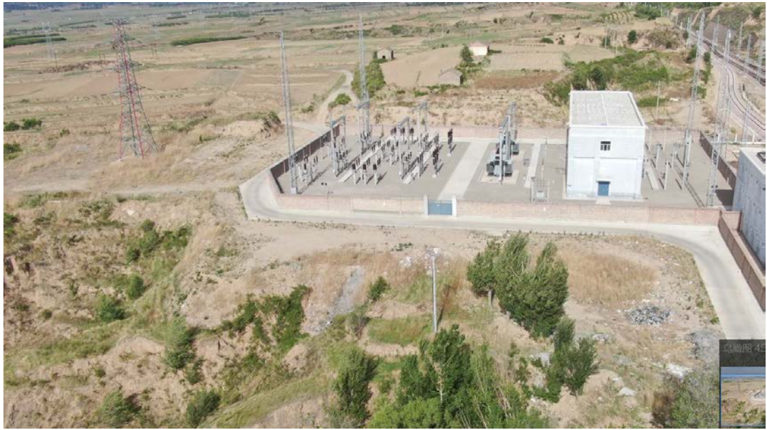
东河南站变电所及已恢复植被的施工营地
