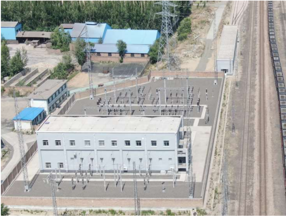
枣林站变电所
