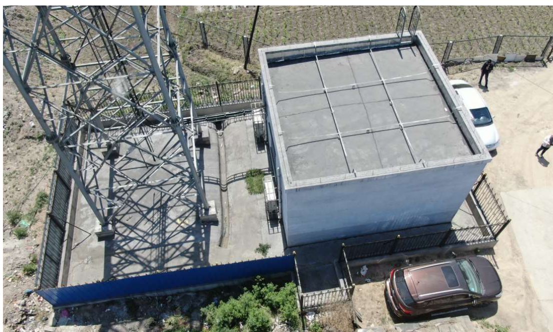
代县站通信基站
