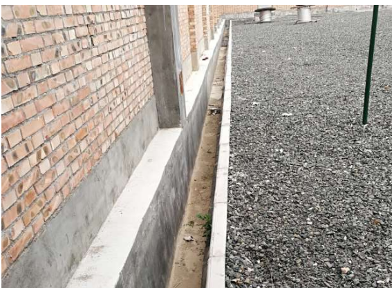
五台站变电所碎石压盖和排水系统
