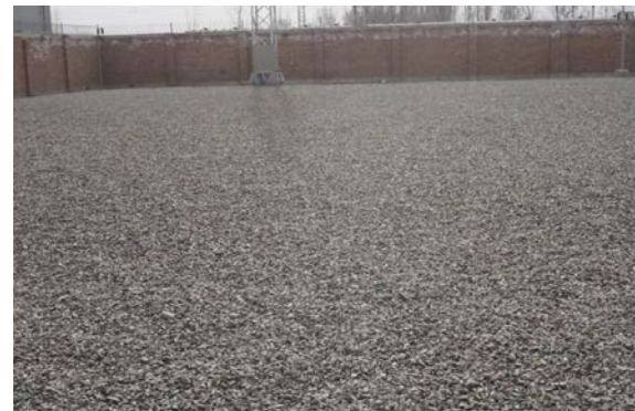
五台站变电所碎石压盖和排水系统
