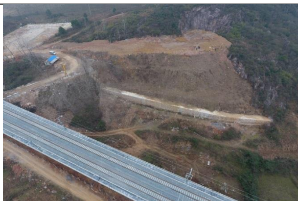
七里冲弃渣场，无排水（2017 年 1 月）
