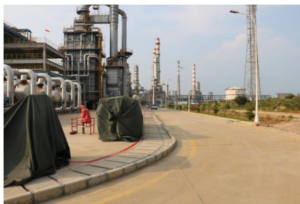
凝析油加氢装置
